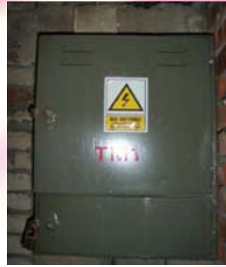
Skrzynka elektryczna z zabezpieczeniami mieszkań.
