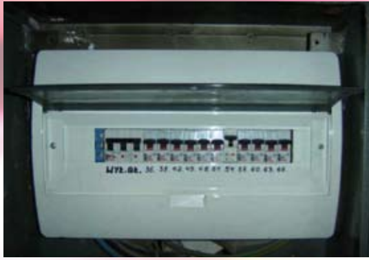
Widok zabezpieczeń po otwarciu skrzynki.
